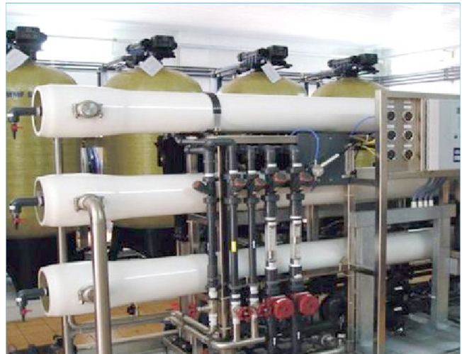
HỆ THỐNG LỌC NƯỚC TINH KHIẾT 20M3/H 20M3/H PUR WATER FILTRATION SYSTEM
