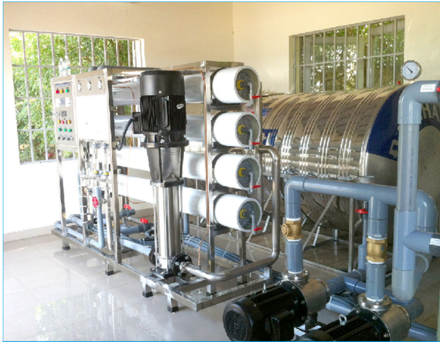
HỆ THỐNG LỌC NƯỚC TINH KHIẾT 10.000L/H 10.000L/H PURE WATER FILTER SYSTEM
