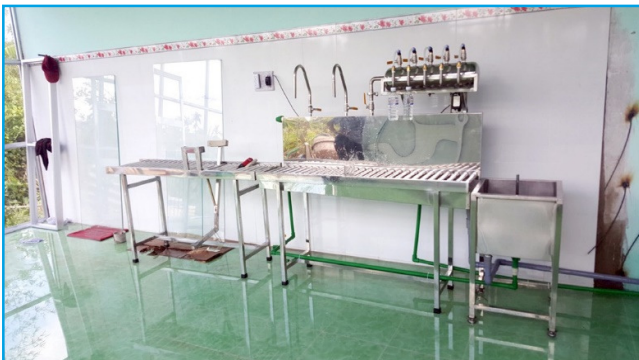
CHIẾT NƯỚC WATER FILLING
