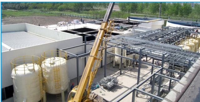
HỆ THỐNG XỬ LÝ NƯỚC THẢI WASTE WATER TREATMENT SYSTEM
