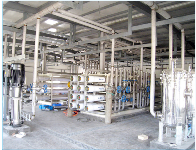
HỆ THỐNG LỌC NƯỚC RO CÔNG NGHIỆP RO INDUSTRIAL WATER FILTRATION SYSTEM
